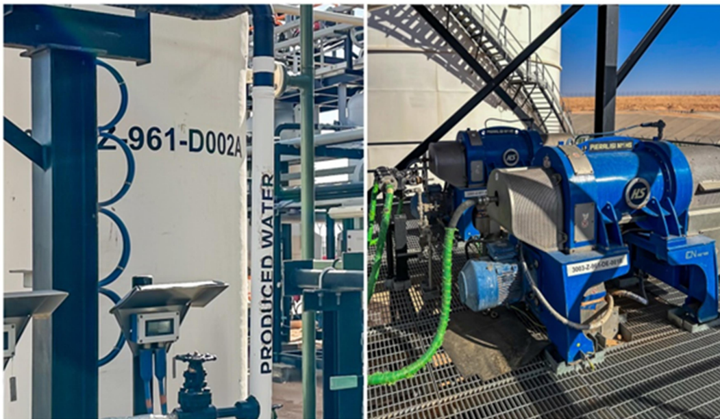
Figure IV.14. Traitement des eaux boueuses.
