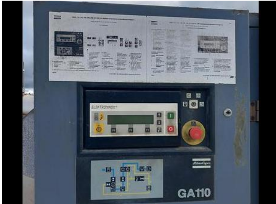
FIGURE 3.3 – Compresseur d'air industriel à vis lubrifié Atlas Copco GA110 : vue générale de face avec panneau de commande électronique touch.
