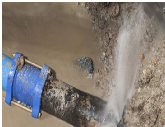
Photo 3.2. Fuite sur une conduite en Acier
