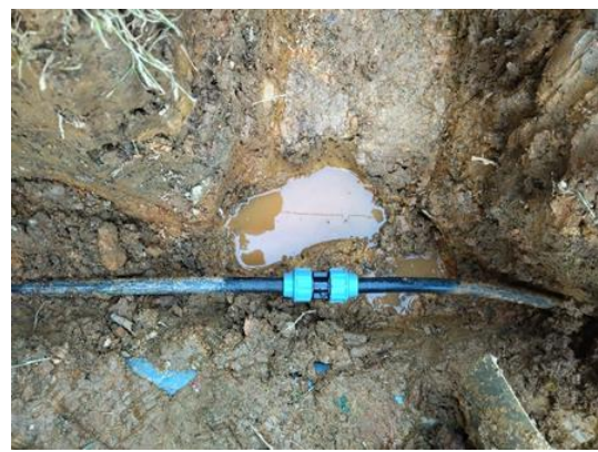
Photo 3.3. Fuite sur un branchement
