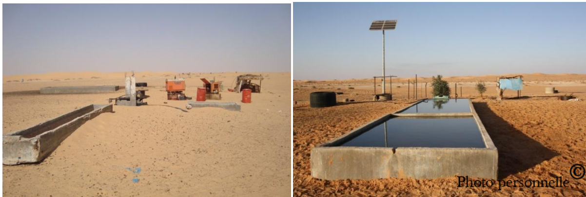
Figure 3 : La station Bir El Gayed avant et après le projet d'installation des générateurs électriques solaires dans les points d'abreuvement des troupeaux camelins
